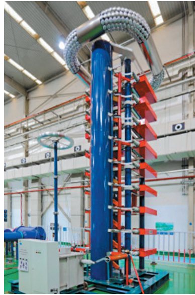
▶ Устройство для испытания грозовым импульсом
